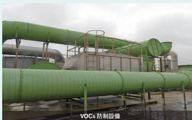
VOCs 防制設備
