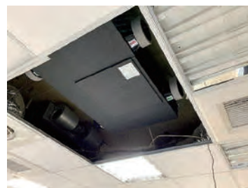
監測辦公室二氧化碳 CO 2 及揮發性有機物 (VOCs) 濃度，並使用日立冷氣全熱交換器產品，改善辦公室室內空氣品質。
