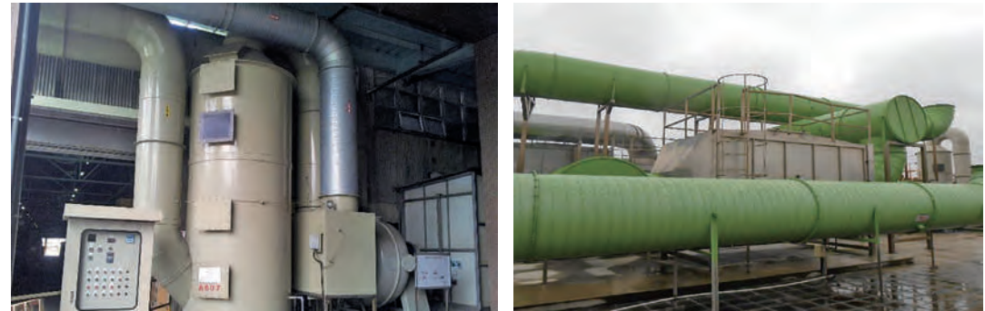
VOCs 防制設備
